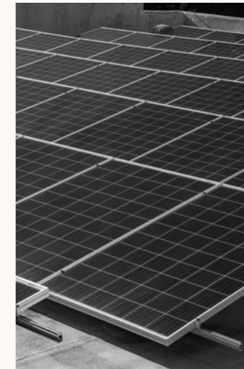
▲ Instalaciones de placas solares
